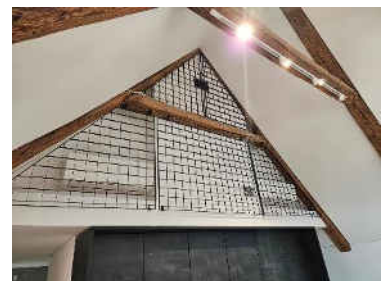
Mrežne konstrukcije povsod, v tem primeru hkrati varujejo klimatske naprave preh mehanskimi poškodbami.
